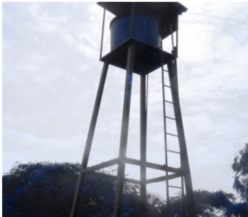
Foto 13. Tanque de almacenamiento empleado en comunidades más pequeñas.
