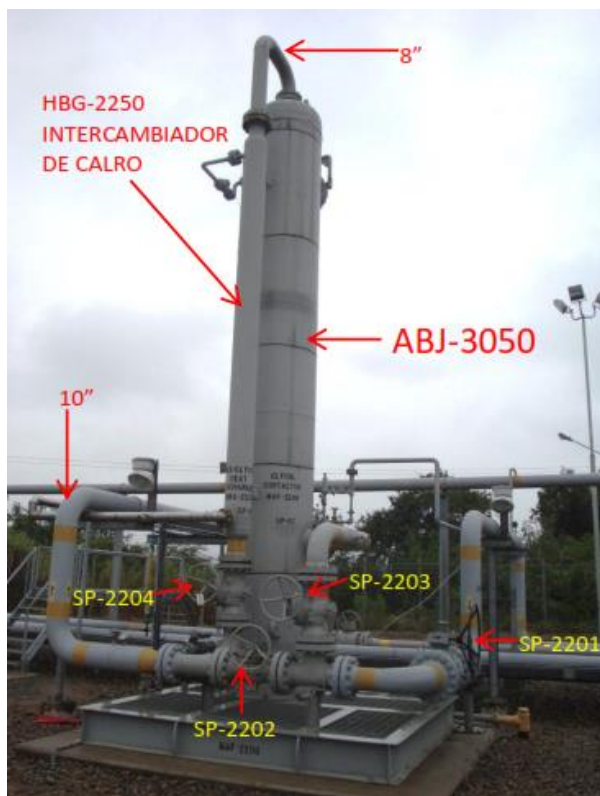
Figura 6: Torre Contactora (Torre de Glycol)
