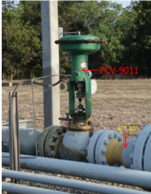
Figura 7: Válvula Reguladora de Presión (PCV-9011)
