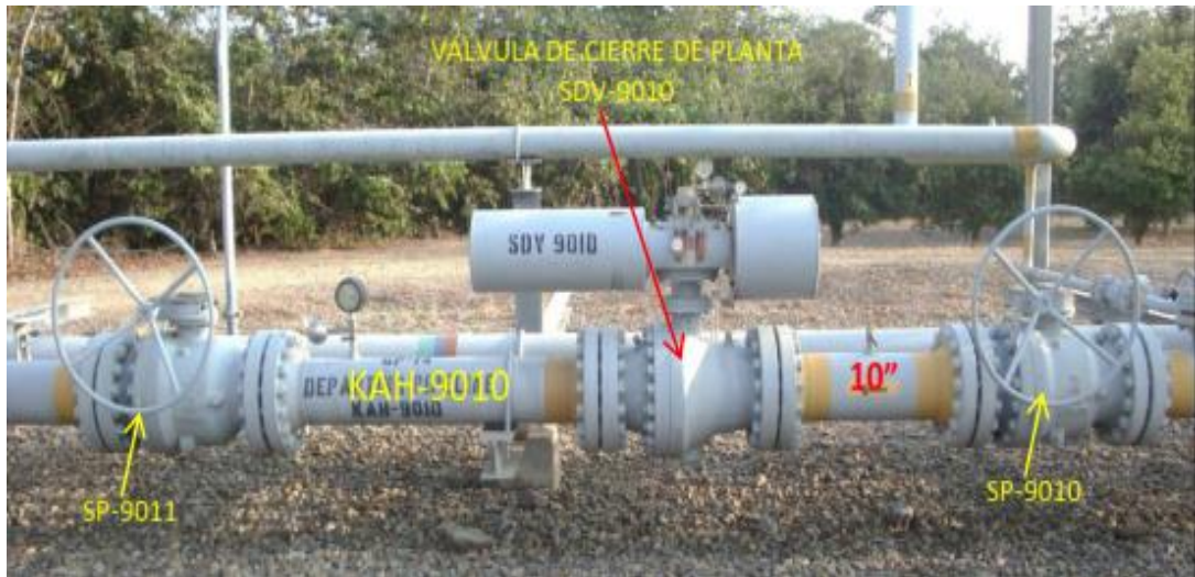
Figura 8: Válvula de Cierre de salida de Planta (SDV-9010)
