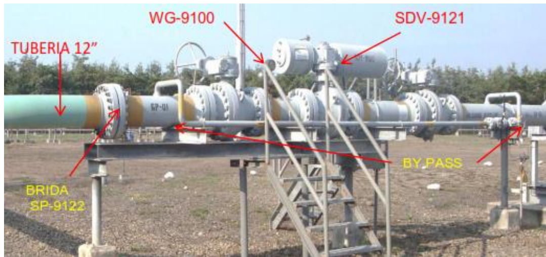
Figura 5: Tubería de ingreso de gas y válvula de cierre de ingreso de planta (SDV-9121)
