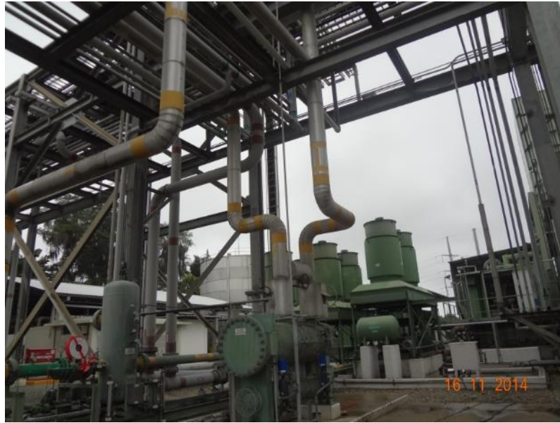
Figura 9: Línea principal de ingreso de gas natural
