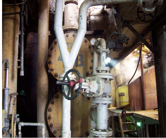
Figura 1.8 Tubería para la dosificación de lechada de cal
