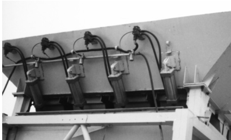
Figura 3.8 – Línea de aire para la tolva de agregados.
