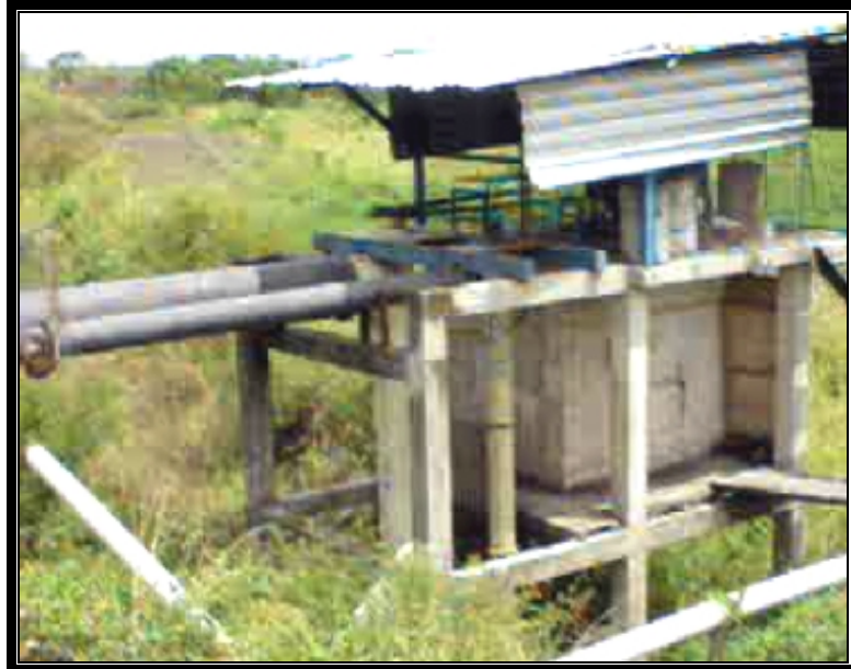
Figura 25. Bomba de Eliminación de Aguas Residuales
