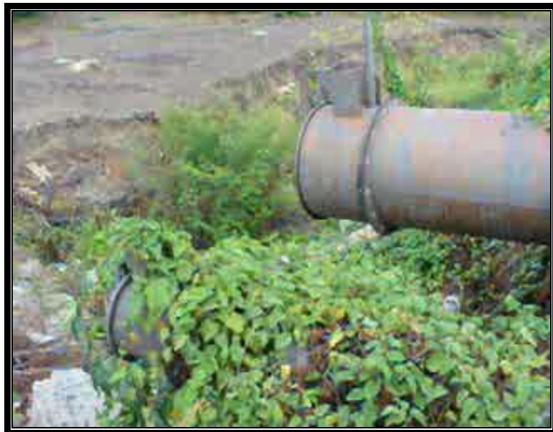
Figura 26. Tubería de Eliminación de Aguas Residuales
