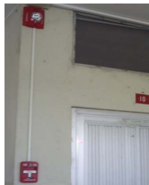
FIGURA 3.6 ALARMA DE FUEGO
