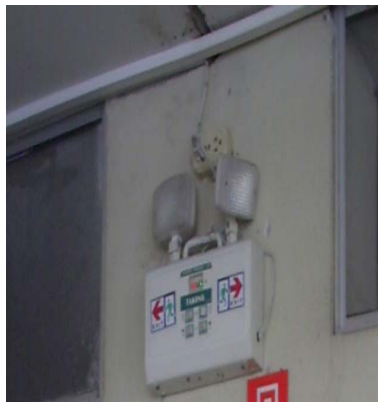
FIGURA 3.5 LUZ DE EMERGENCIA
