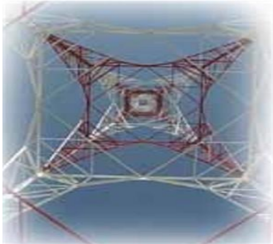
FIGURA 1.2 TORRE AUTOSOPORTADAS PATA ANGULO
