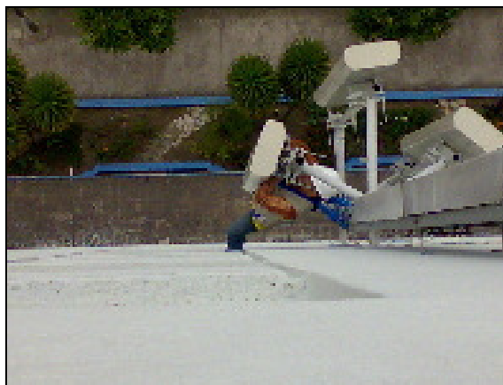
Figura 2.3 Ajustes mecánicos en una celda UMTS
