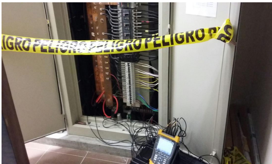
Figura 3 Medición en las celdas de acondicionadores de aire conservando la zona de seguridad
