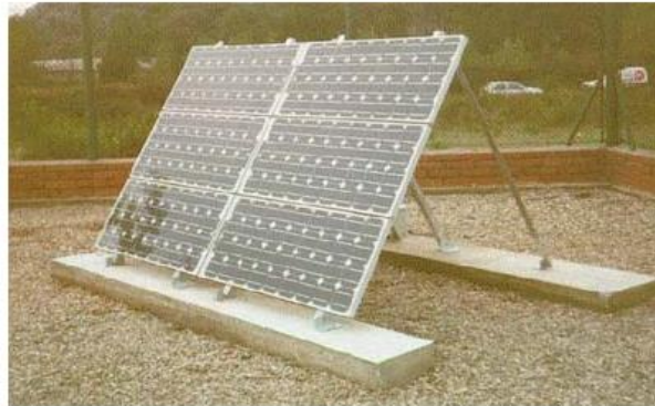
Figura 3.73 Vista de la estructura fotovoltaica [27]
