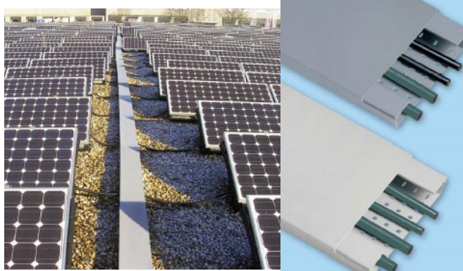
Figura 3.83: Canaletas para instalación fotovoltaica [46]
