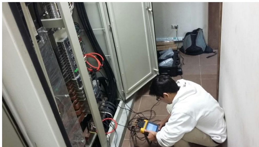
Figura 2: Configuración del equipo de medición en las celdas del cuarto eléctrico del edificio
