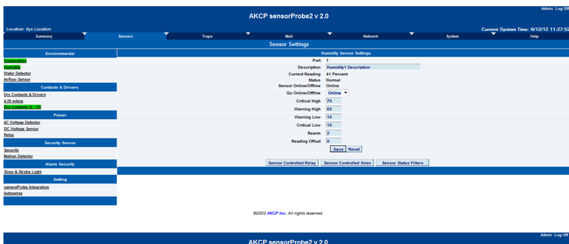
Figura 3.66 configuración de humedad del AA Liebert
