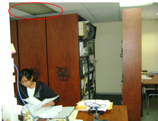
Imagen 6. Luminarias sin mantenimiento.
