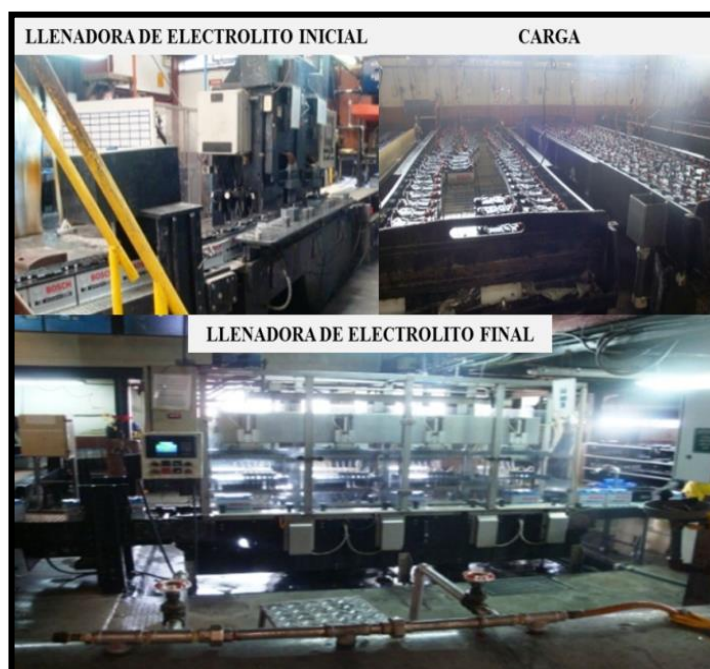
Ilustración 11: Carga de las Baterías
