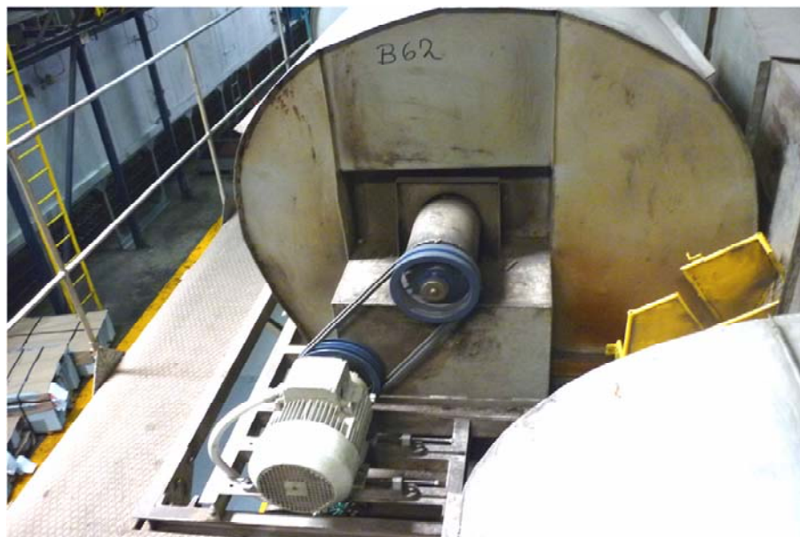
Figura 10. Motor y ventilador de aire caliente zona de cocción.
