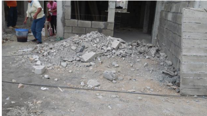
Figura 4.3. Bloques de mampostería rotos Fuente: Tomada por los autores
