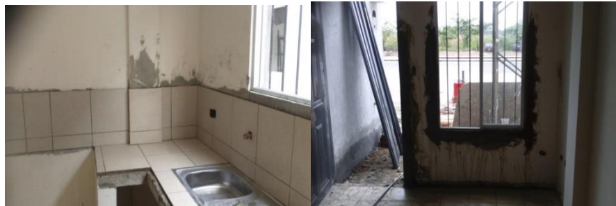
Figura 4.7. Descoordinación entre trabajos.
