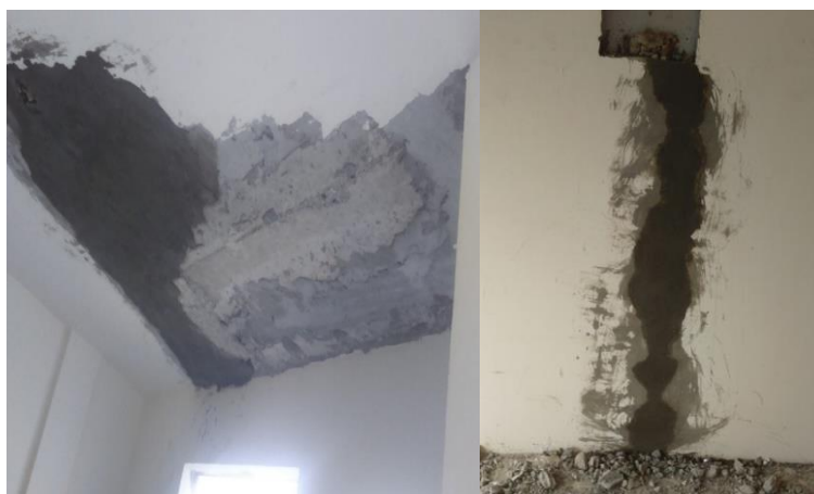
Figura 4.11. Trabajos rehechos en la construcción Fuente: Tomada por los autores
