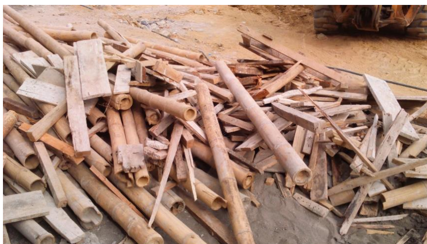
Figura 4.6. Madera para encofrado desperdiciada. Fuente: Tomada por los autores
