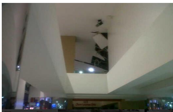
Figura 1.1: Parte del techo destruido en Centro Comercial. [6]
