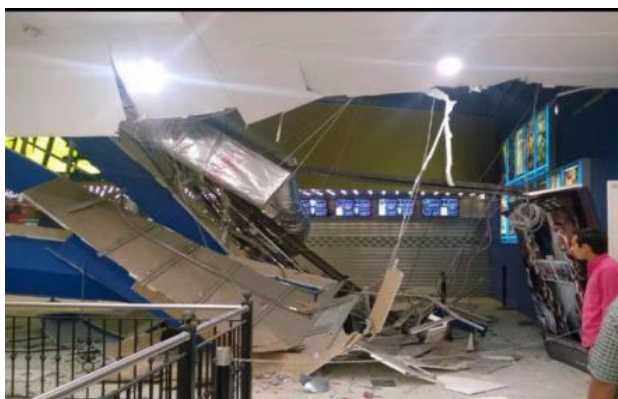
Figura 1.4: Techo destruido en exteriores del cine de un Centro Comercial. [9]
