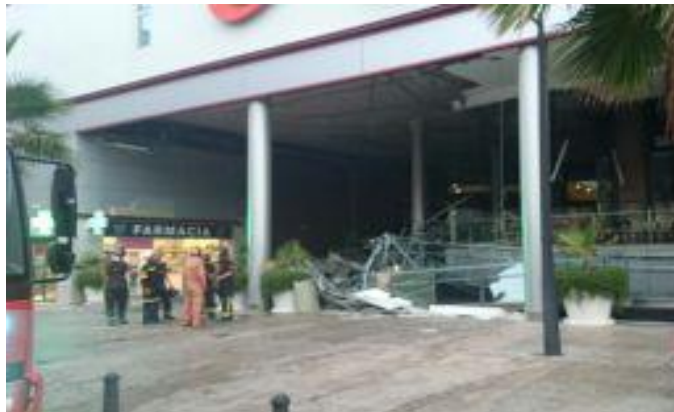
Figura 1.2: Parte del techo colapsado en Centro Comercial. [7]
