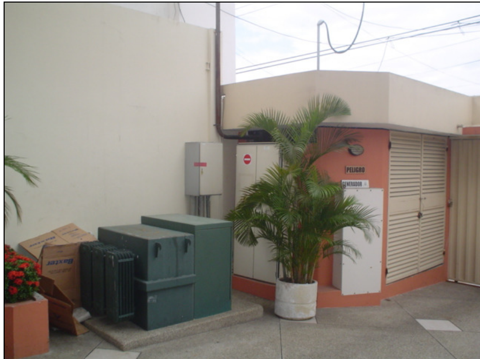
Figura 3.3.1b - Transformador y cuarto del grupo electrógeno
