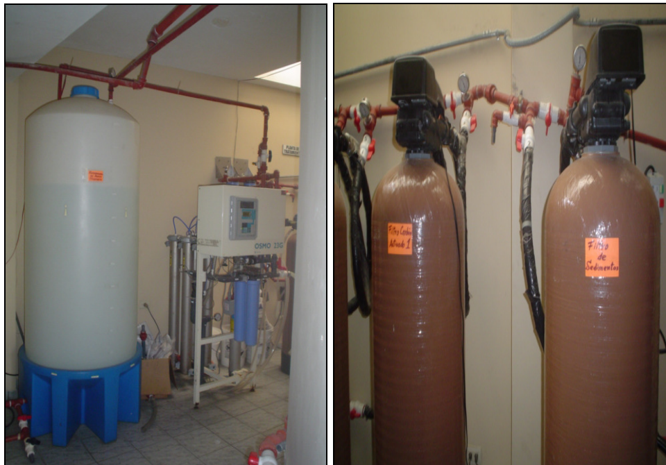
Figura 3.3.1d - Planta tratadora de agua
