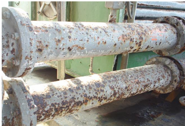
Figura 1.2: Corrosión en tuberías de agua helada
