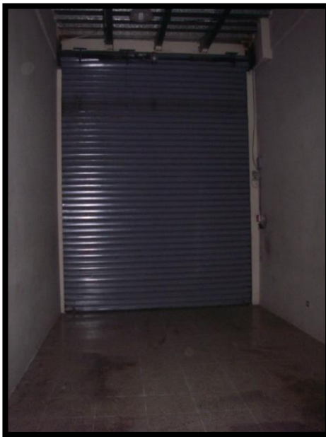
Figura 2.6 Falta de señales
