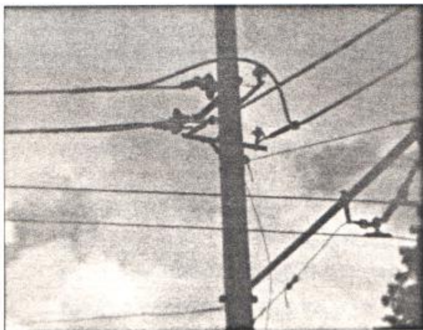
FIGURA No. 4.34 POSTE CON CRUCETAS DE HIERRO ANGULAR MONTADOS ADECUADAMENTE PARA UN CAMBIO DE RUTA DE LA LINEA DE ALIMENTACION.
