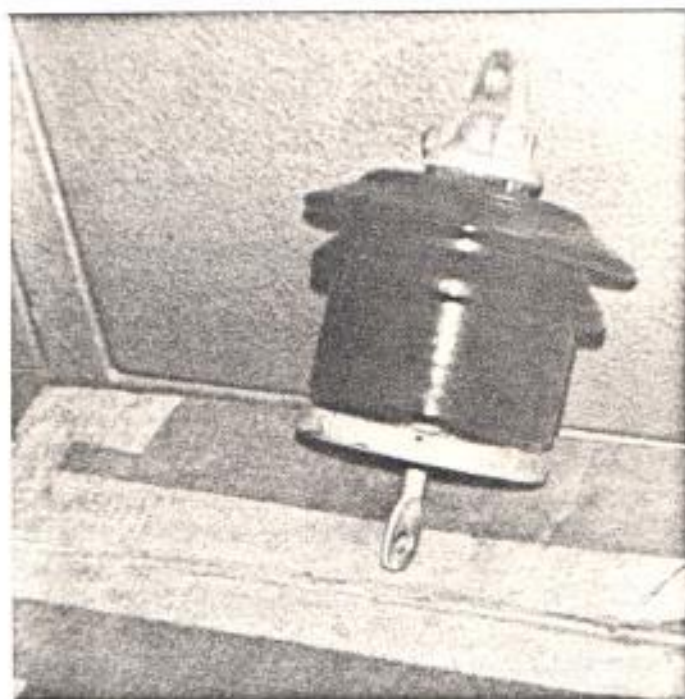
FIGURA No. 4.49. REACTOR DE PUESTA A TIERRA DEL TRANSFORMADOR.
