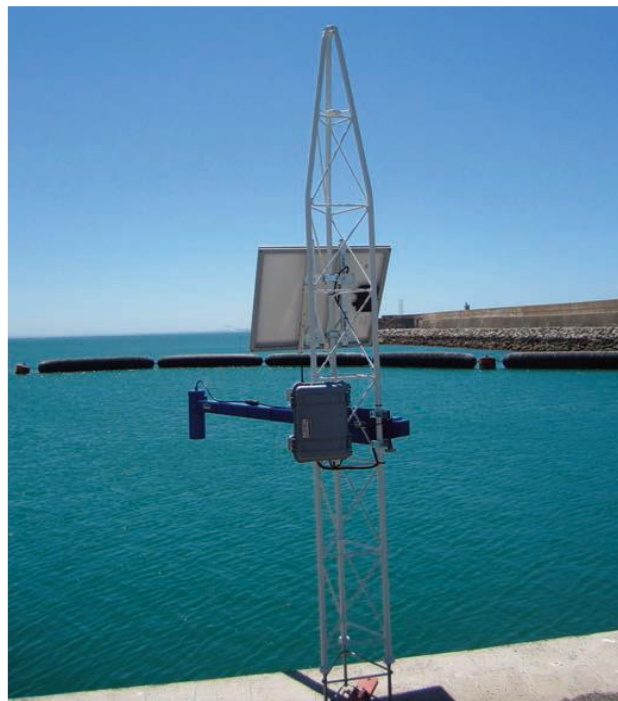
Figura 3.11: Sistema de energía solar para mareógrafo instalado [34]
