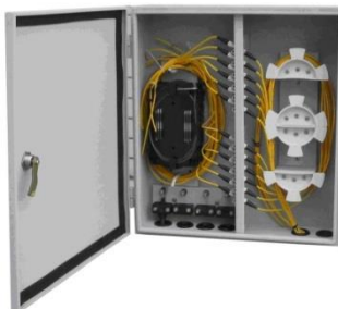
Figura 3.8: Caja repartidora de fibra óptica.
