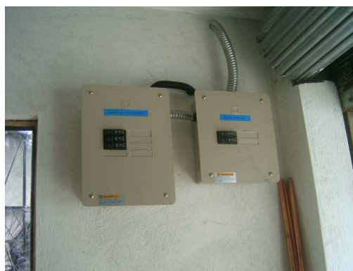
Fig. 4.11.- Tablero Principal de alimentación y tablero de distribución
