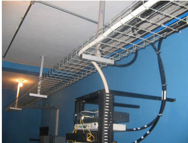
Fig. 4.2.- Bandeja para tendido del cable en el interior del cuarto de equipos
