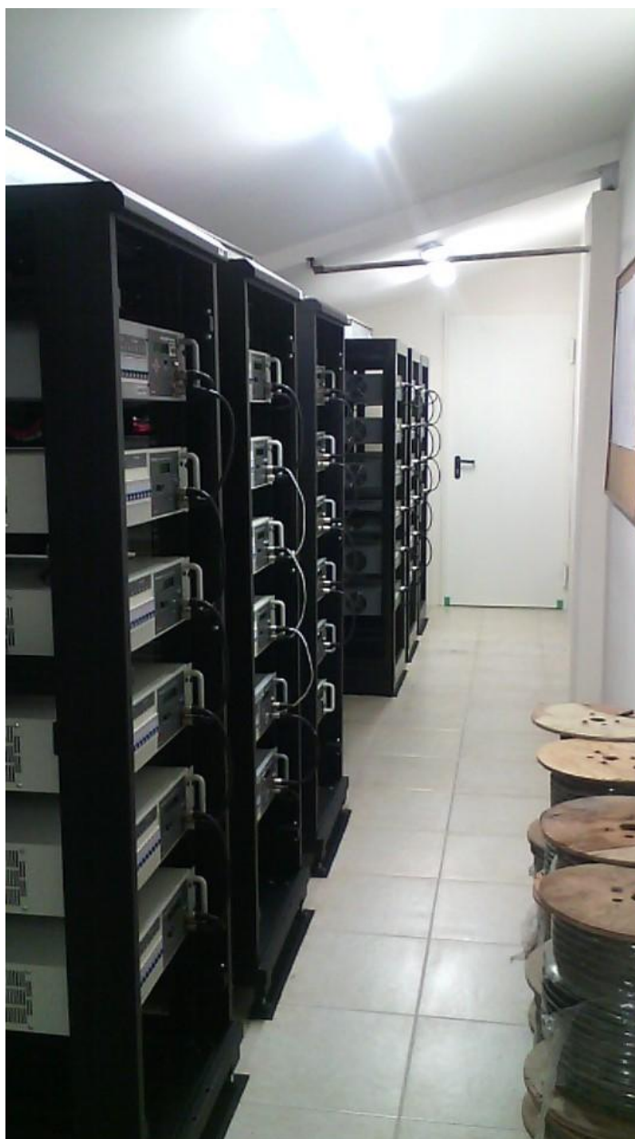
Figura 2.2: Cuarto de dimmer
