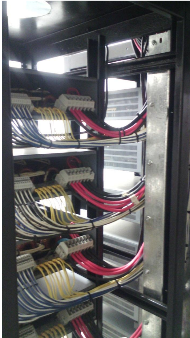
Figura 2.8: Acometidas a Rack de dimmer
