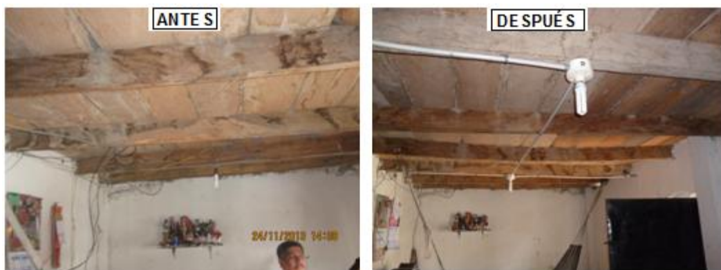
Figura 3. 48: Eliminación de instalaciones peligrosas a través de tuberías
