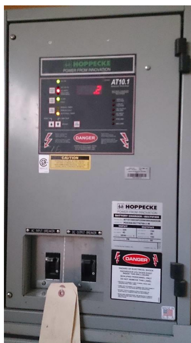
Figura 1. 17: Cargador del banco de baterías
