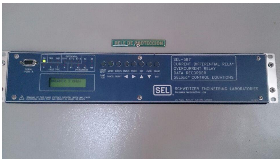
Figura 1. 21: Panel frontal del relé SEL 387
