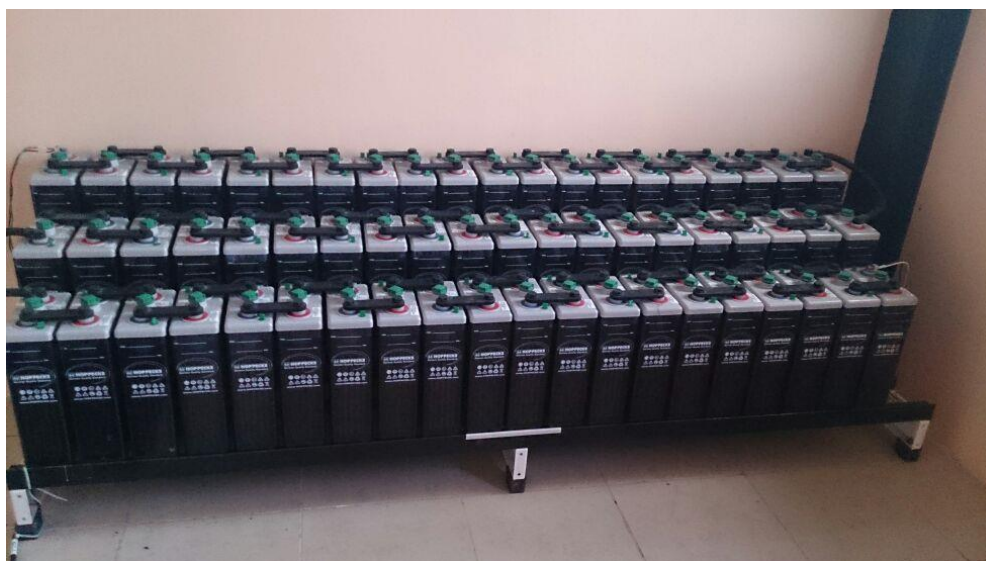
Figura 1. 16: Banco de baterías
