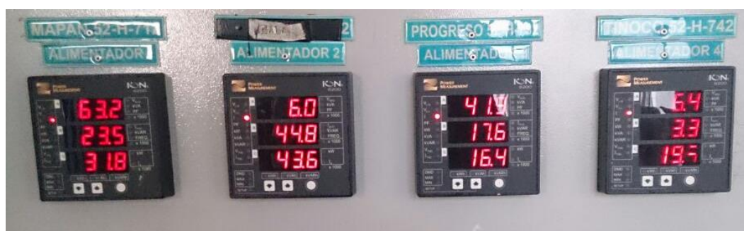
Figura 1. 20: Medidor de energía ION6200
