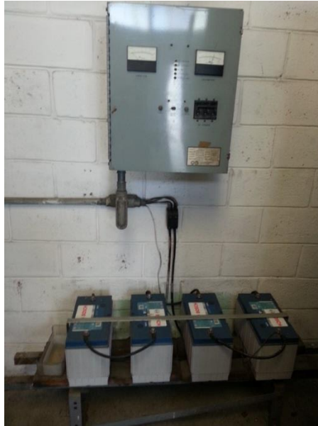
Figura 1.13 Cargador GNB y baterías BOSCH.
