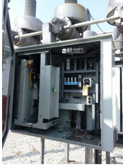
Figura 1.5 Vista interior del control del interruptor SF6.
