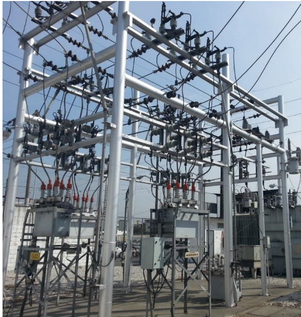
Figura 1.9 Patio de 13.8 [KV].
