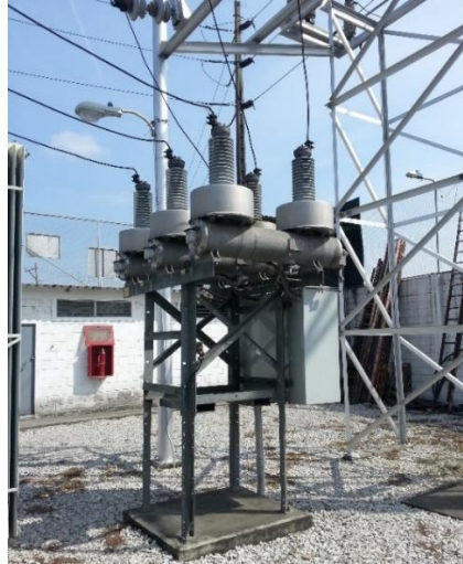
Figura 1.6 Interruptor en gas SF6.
