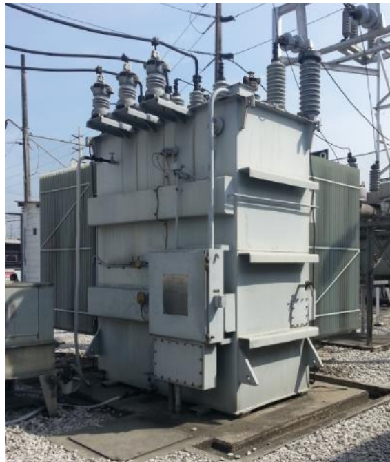
Figura 1.8 Transformador principal de la Subestación Garzota
