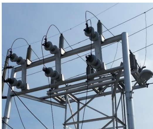
Figura 1.7 Aisladores a 69 [KV].
