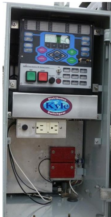
Figura 1.10 Vista interna del controlador Cooper forma 6.
