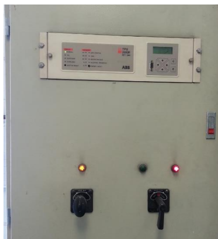
Figura 1.15 Panel de control con el relé TPU2000R.
