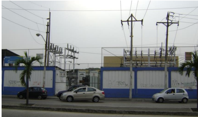
Figura 1.2 Vista exterior de la subestación Garzota.
