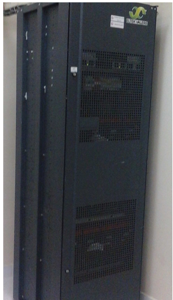
Fig. 5.16 Equipo con conexión a tierra
