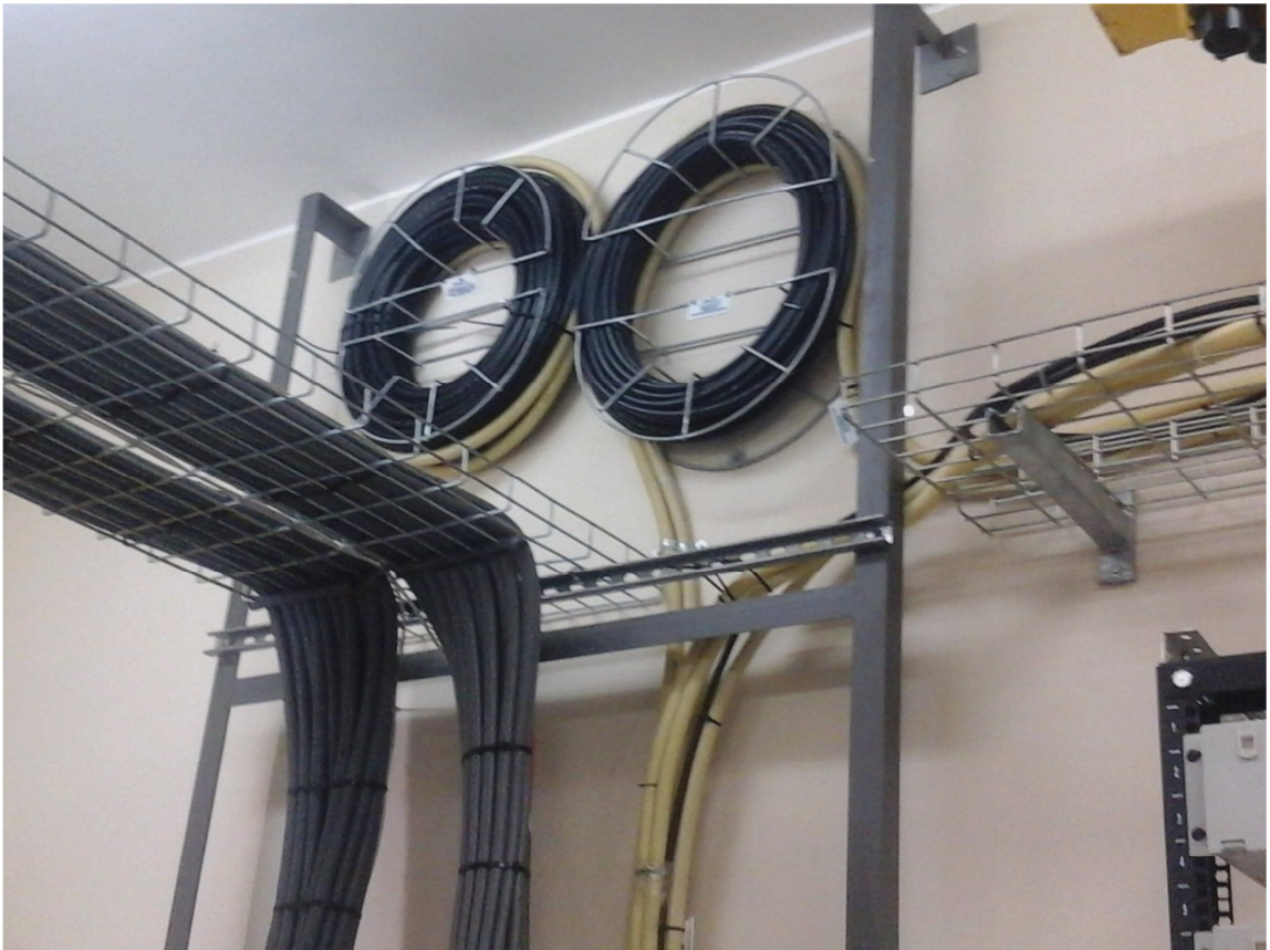
Fig. 5.18 Cable eKkx y Fibra Óptica
