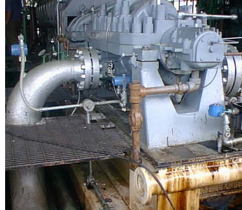
Instrumentos Descarga de la Bomba
