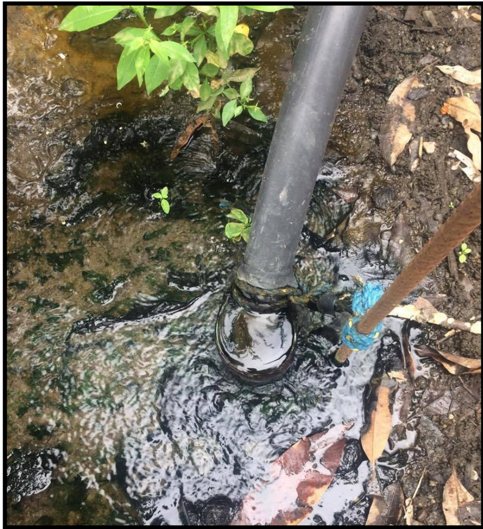
Figura 1.1.3. Salida de tubería proveniente del pozo
