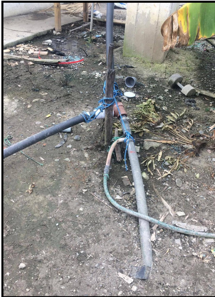
Figura 1.1.4. Conexión de mangueras inapropiadas
