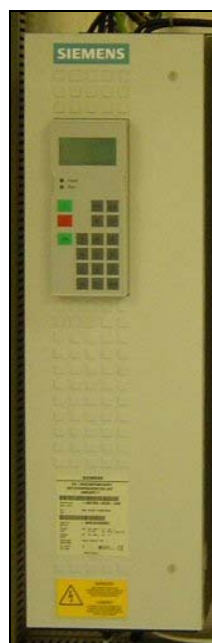
Figura 3.15: Rectificador marca SIEMENS
