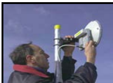
FIGURA 1.70: Antena directa instalada en emplazamiento usuario (30-35 dB)
