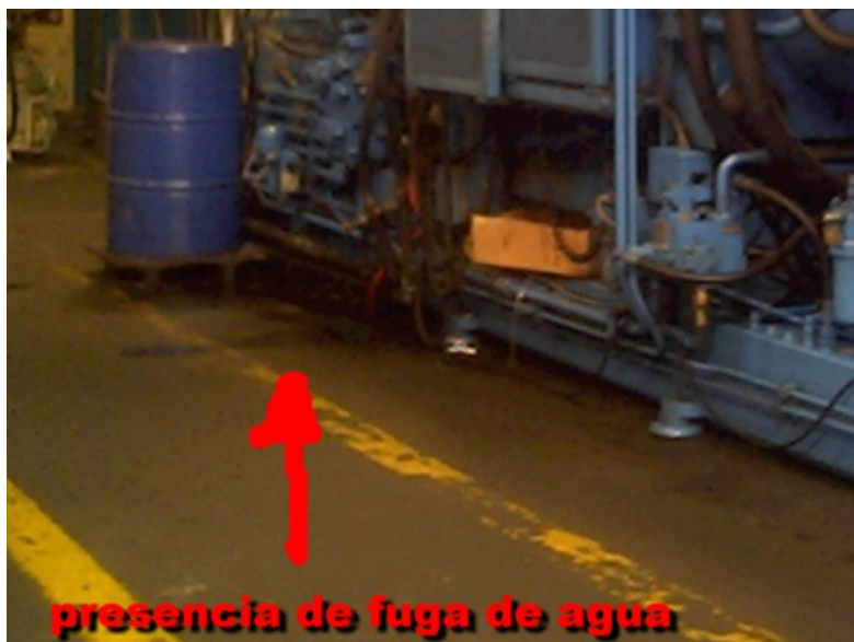
Figura 9.3.2 Punto de frecuente limpieza – puntos de fugas de agua
