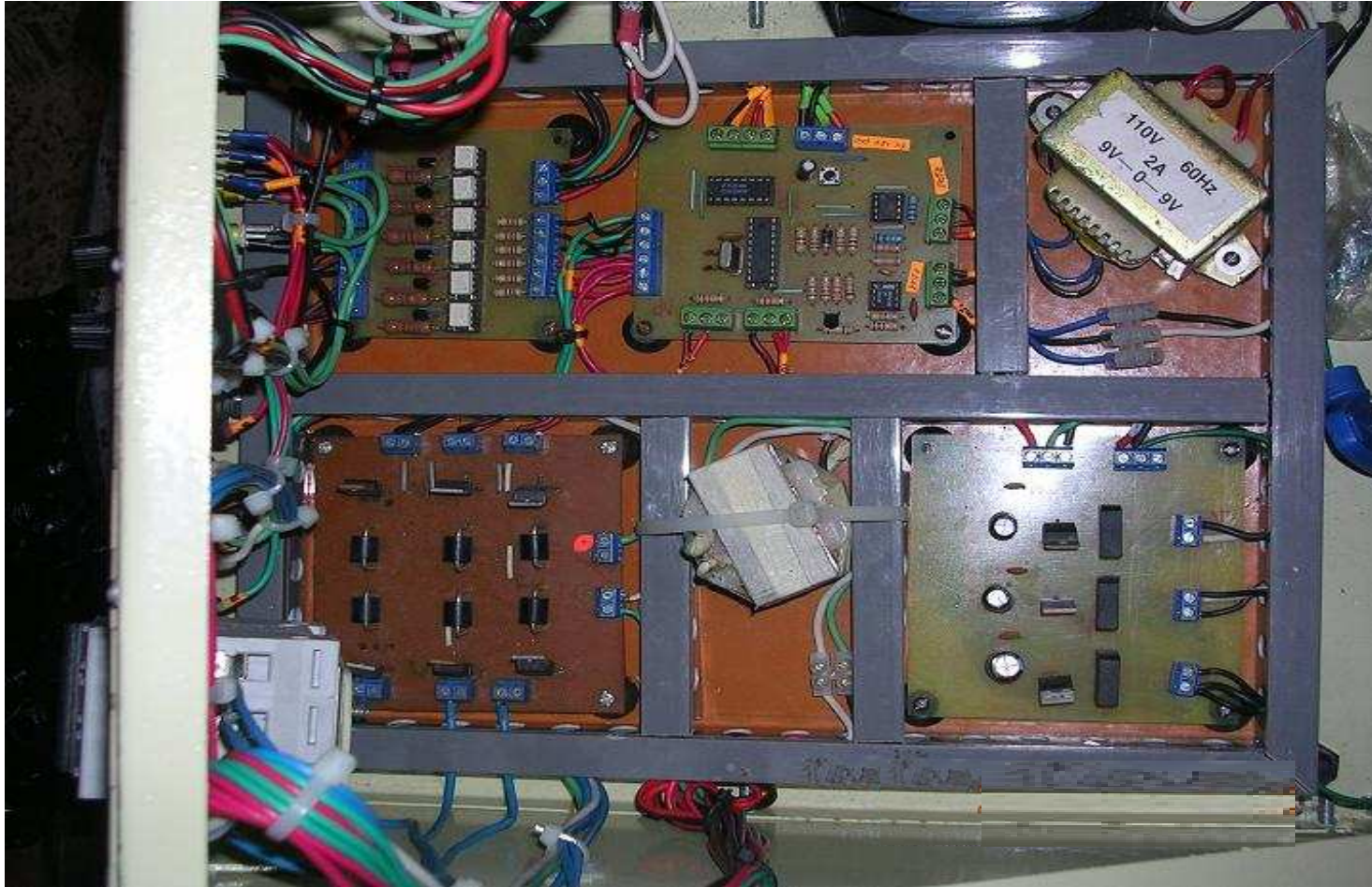
Vista Superior de la ubicación de las tarjetas en el interior de la caja del inversor
