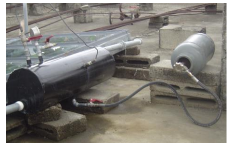
Fig. 4.4 Suministro de amoniaco al sistema
