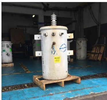
Figura 1.8 Transformador de poste de 50Kva.
