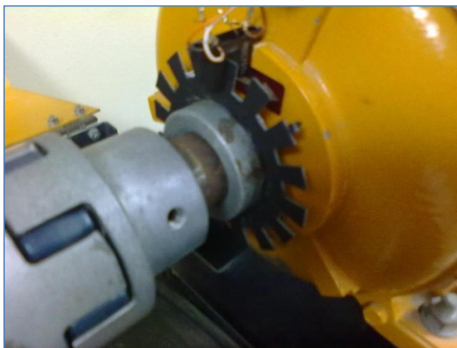
Figura 3-6 Encoder Acoplado con Sensor MOC70T3 al motor.
