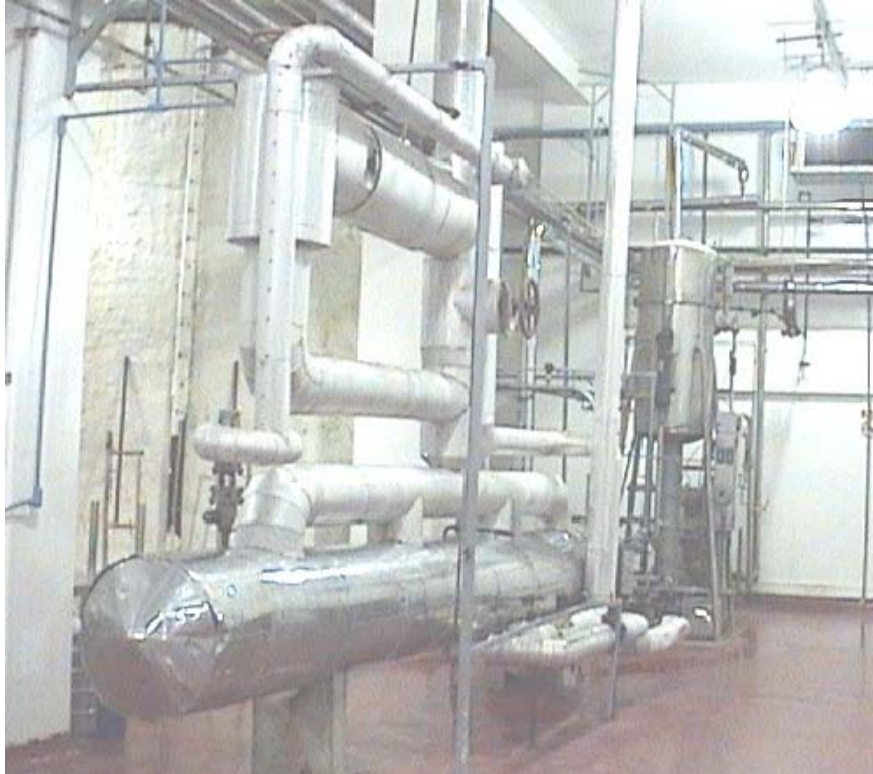
FIGURA 1.8 ENFRIADOR DE AGUA DESAIREADA.
