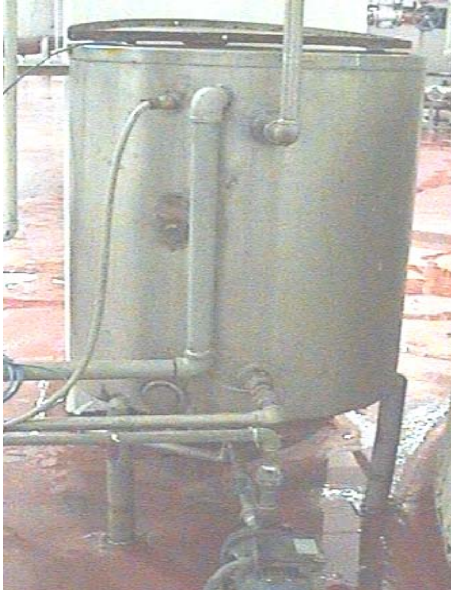
FIGURA 2.5 TANQUE DE AGUA PARA RECIRCULACIÓN.
