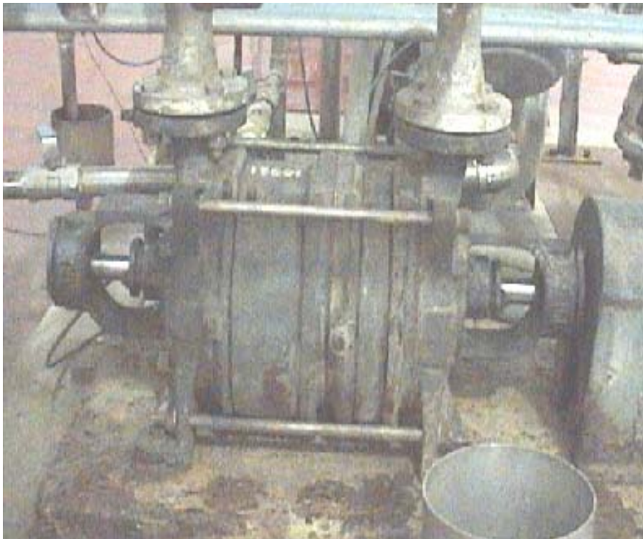
FIGURA 1.9 BOMBA DE VACIO.
