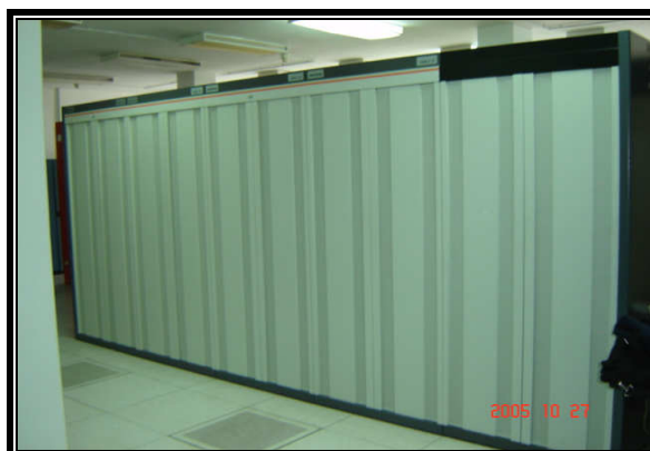
Figura 3.1 Central telefónica Alcatel 1000 de Samanes
