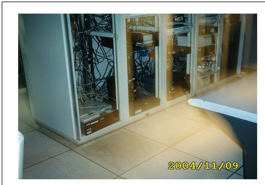
FIGURA 2.1.1.1 RACK DE COMUNICACIONES UIO
