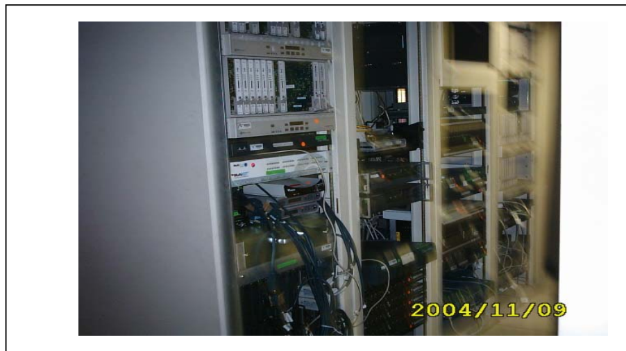
FIGURA 2.1.2 RACK DE COMUNICACIONES DEL CLIENTE.
