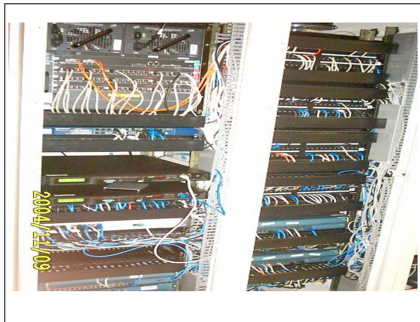
FIGURA 2.1.5 RACK DE SWITCH 4506 DEL CLIENTE
