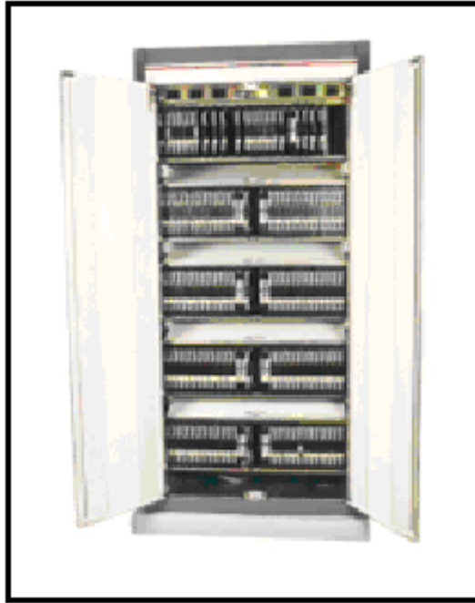
Figura 2.32 Central Alcatel 1000 E1
