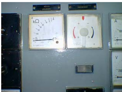
MEDIDOR DE AISLAMIENTO Y SINCRONOSCOPIO
