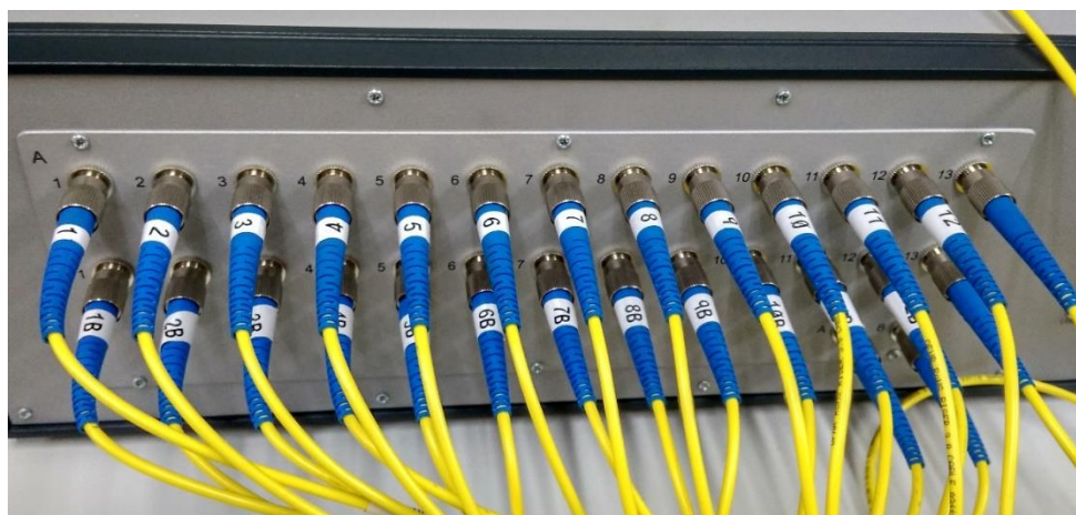
Figura 3.11 Conexiones pigtails patch cord FC/UPC de las 12 fibras en el analizador
