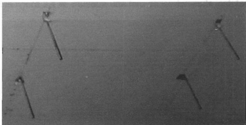
FIGURA 3.2. VARILLAS DE ANCLAJE DE LOS FAN-COILS
