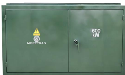
Ilustración No. 7 Cámara de Distribución
