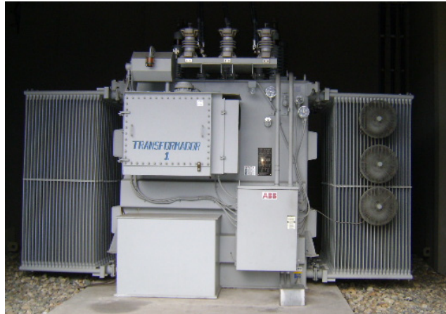
TRANSFORMADOR DE PODER 1 Grafico 44
