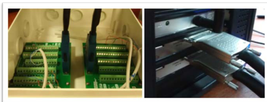
FIGURA 1.51. DETALLE DE LA CAJA DE CONEXIONES, BORNERAS Y TARJETAS DE ADQUISICIÓN DE DATOS
