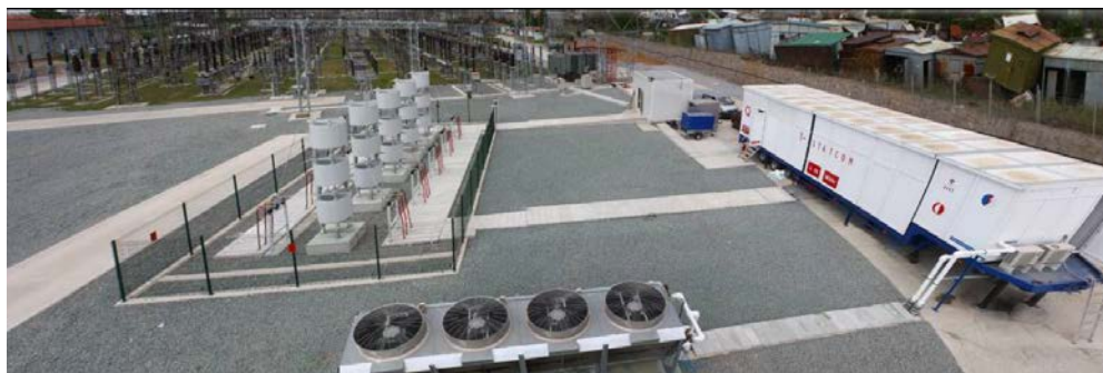
Fig. 3.2. Vista general de un STATCOM en una subestación.
