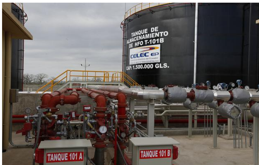
Figura 1.10 Tanque de almacenamiento FUEL OIL 6
