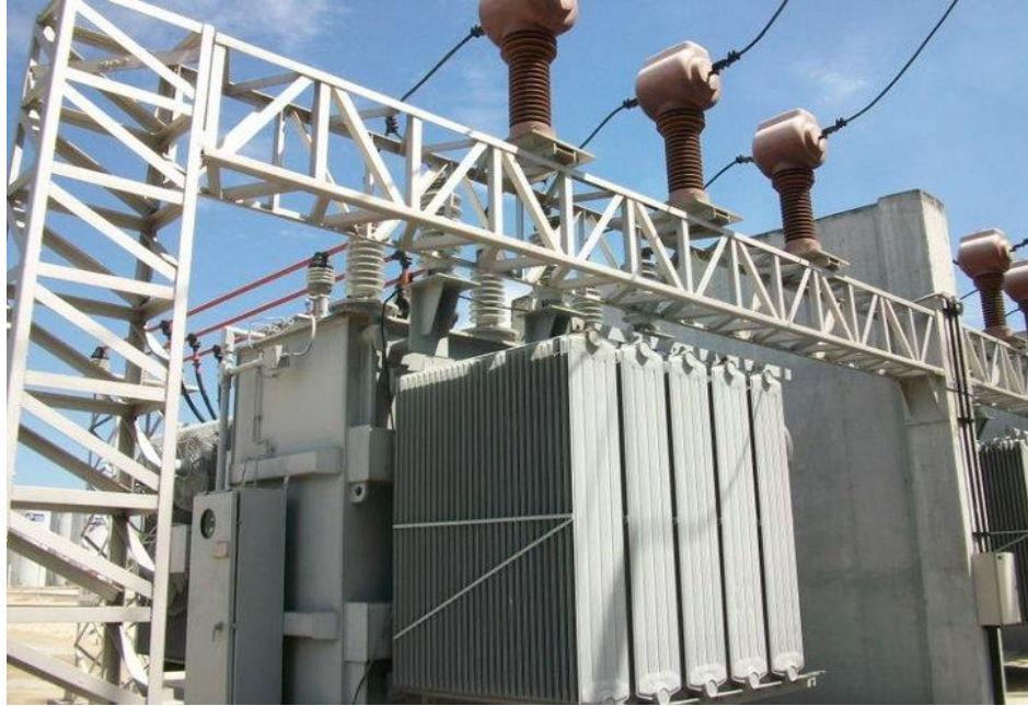
Figura 1.8 Transformador de Potencia
