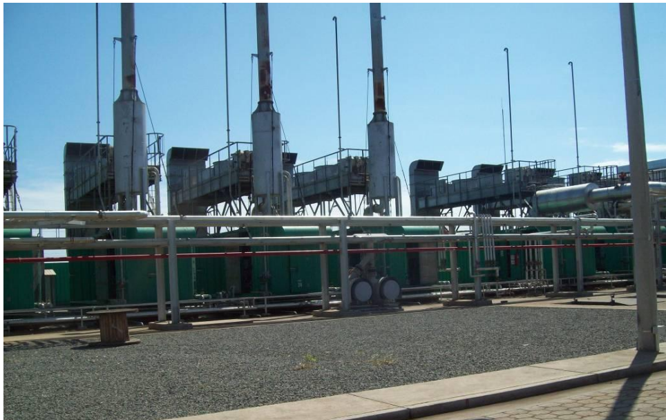
Figura 1.7 Vista externa del generador con las chimeneas
