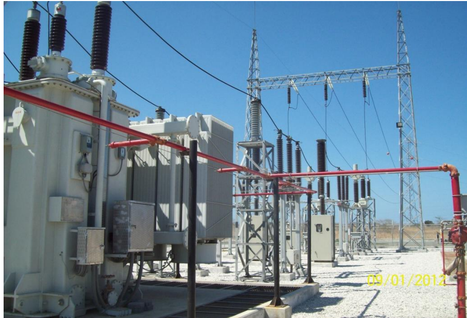
Figura 1.9 Transformador de Potencia conectado al S.N.I.
