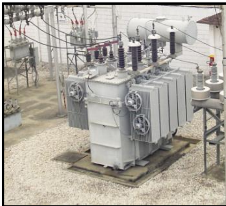
Figura 2.7 Transformador de Fuerza de la Sub. Guayacanes
