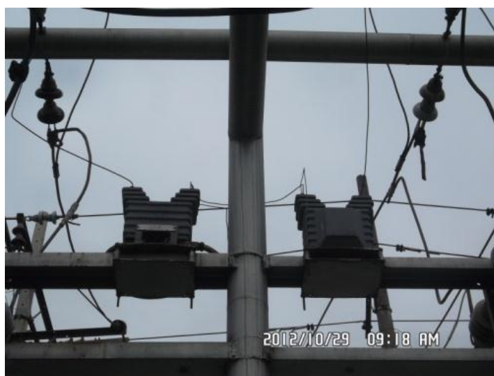
Figura 1.6 Transformadores de Potencial
