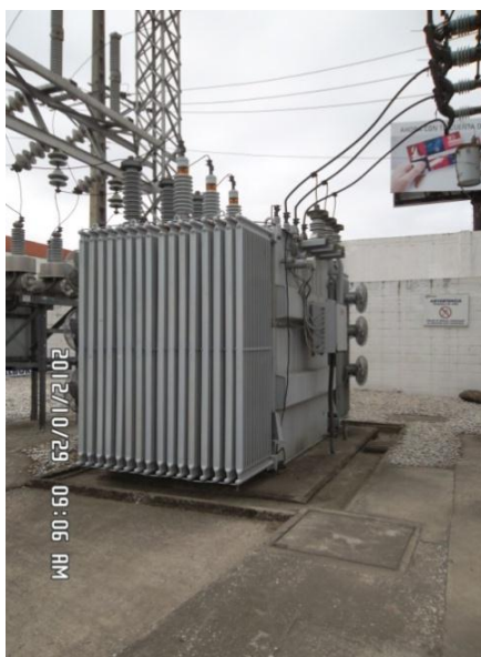
Figura 1.3 Transformador de Poder
