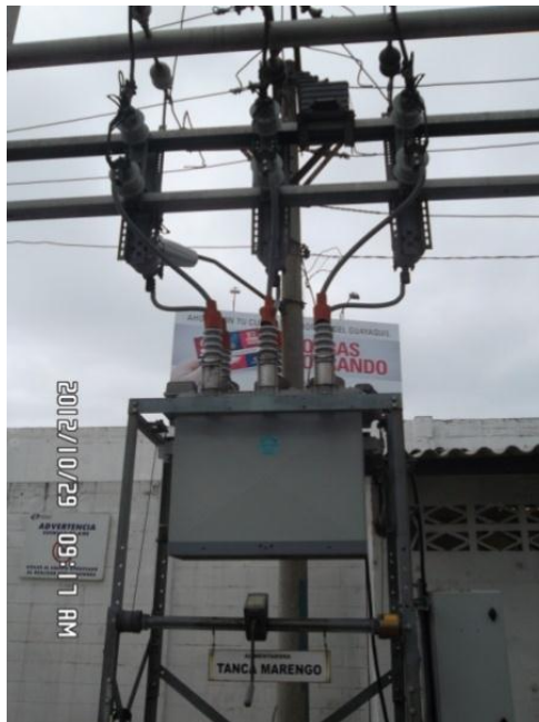
Figura 1.4 Estructura de Seccionadores de la alimentadora Tanca Marengo
